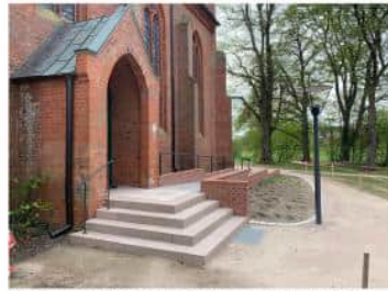
BV Erneuerung der Kirchenportale, Beleuchtung und barrierefreie Rampe St. Laurentius Kirche (Kirchgellersen)
