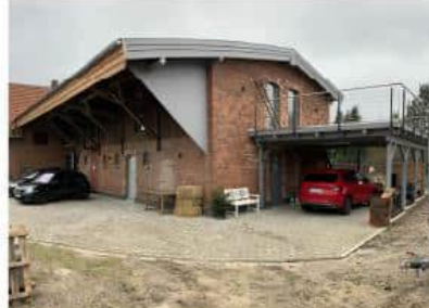
BV Umnutzung ehemalige Wagenremise zu zwei Wohneinheiten inklusive Innenausbau, Erneuerung Hofpflaster (Kirchgellersen)
